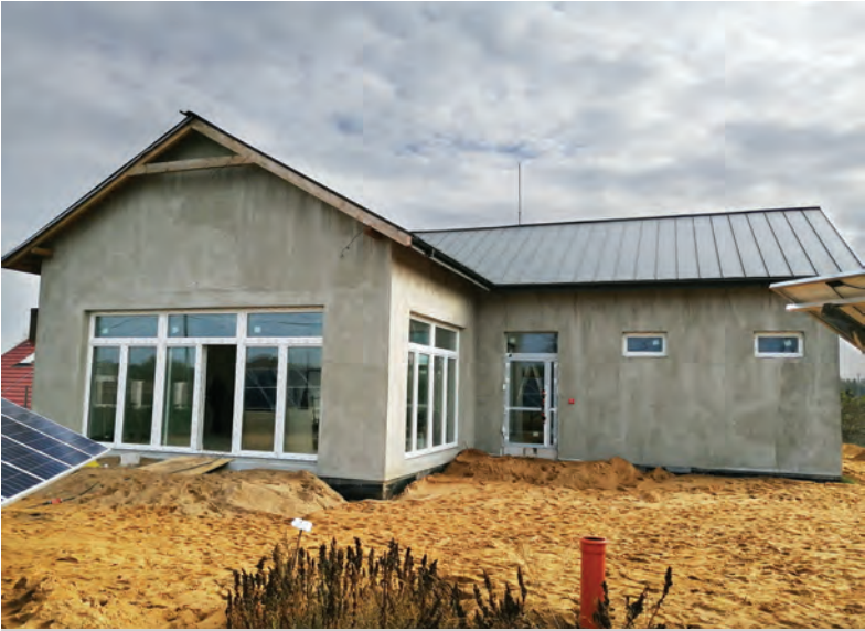
Fot. Marek Kwiatkowski Obiekt będzie korzystał z odnawialnych źródeł energii
