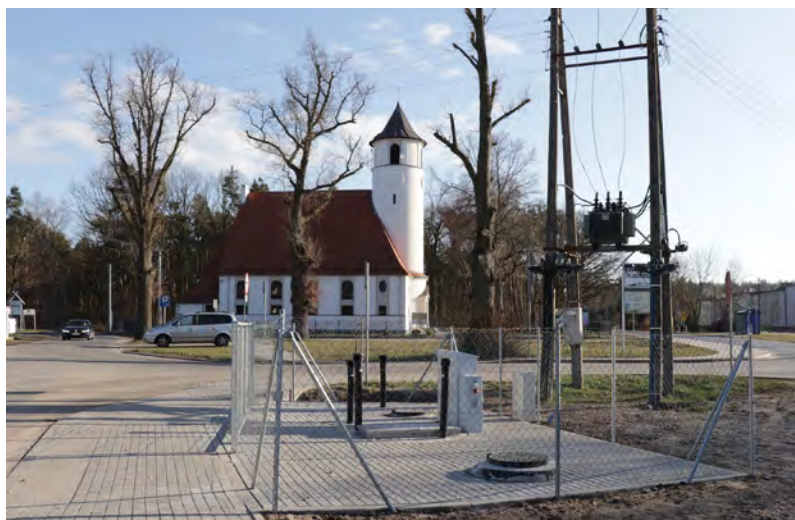
Przepompownia ścieków w Grabowcu
