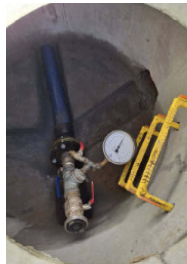
Studnia kanalizacyjna w Krobi. Fot. (MJ)
